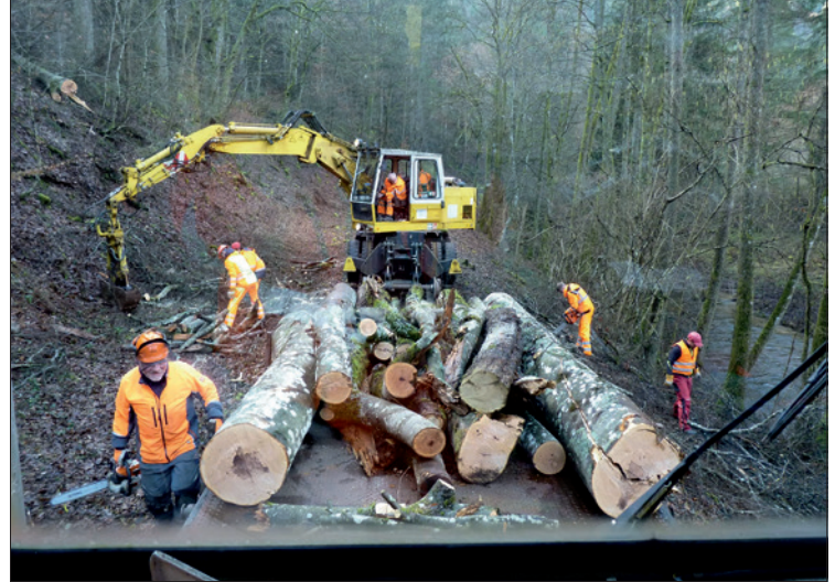
Bei Streckenkilometer 8,3 waren mehrere Bäume aufs Gleis gestürzt, die zersägt und dann mit dem Skl abtransportiert werden mussten.
