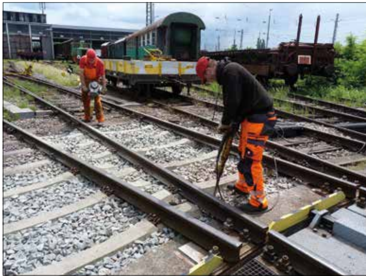
Bei mehreren Anschlussgleisen der Drehscheibe mussten die verrotteten Holz- durch Betonschwellen ersetzt werden. Reiner Frank
