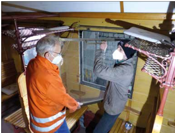
Hier müssen Standschäden beseitigt werden. Michael und Simon bauen aus dem Ci bay 30 die Fenster und Fensterheber aus.
